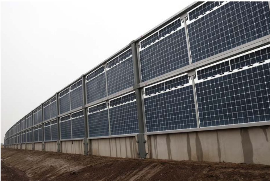
Referentie zonnepanelen in geluidswerende maatregel
